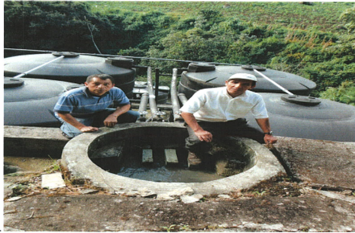
Vista parcial de la Planta de Tratamiento de Aguas Residuales -PTAR-, de la cabecera municipal de San Antonio Sacatepéquez, San Marcos.
