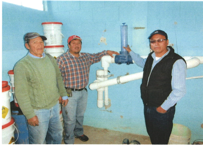
Sistema de cloración (termo cloro en este caso), para el tratamiento del agua que abastece a la cabecera municipal.
