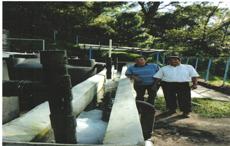
Parte final del tratamiento que se practica a las aguas servidas, previo a su disposición en el río Tacaná.
